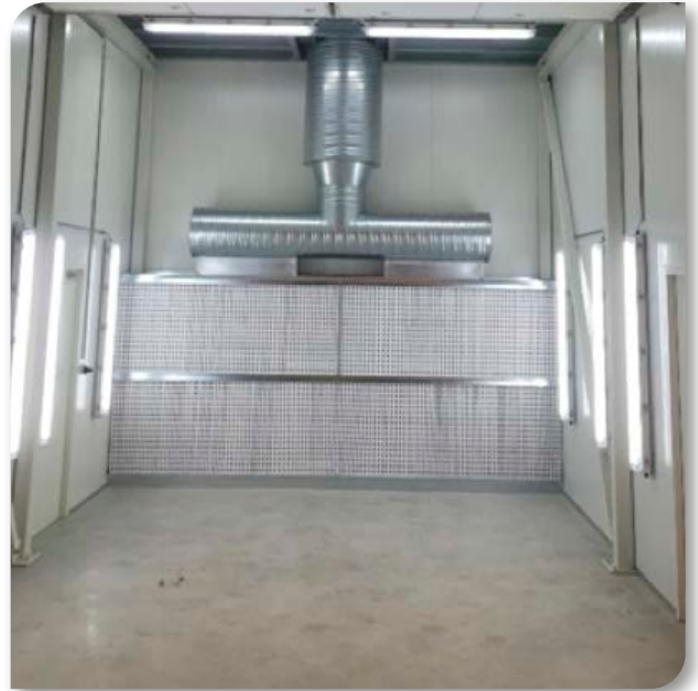
Oben: Abluftabsaugung an der Rückwand.
