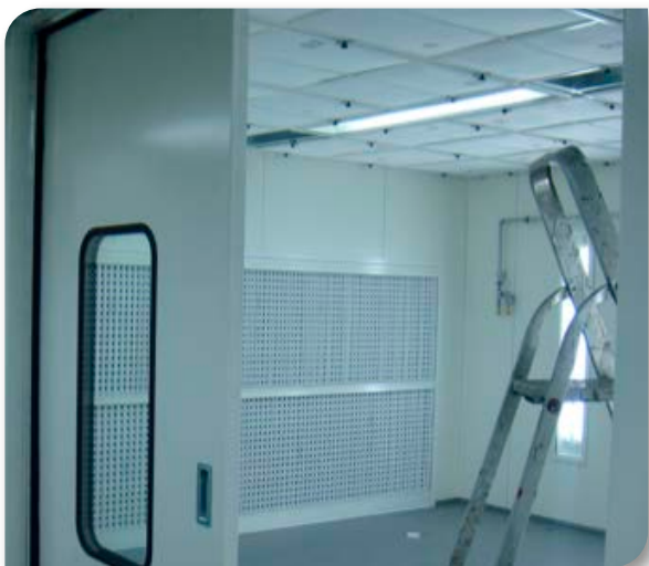
Oben: Halden Fengsel, Norwegen. Abluftabsaugung an der Rückwand, Lufteinblasung von Zuluft in der Decke.
