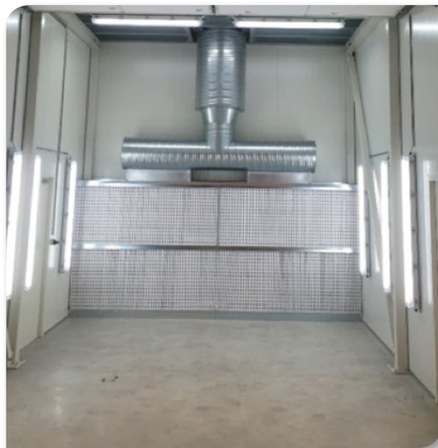
Ovenfor: Udsugning i bagvæggen.
