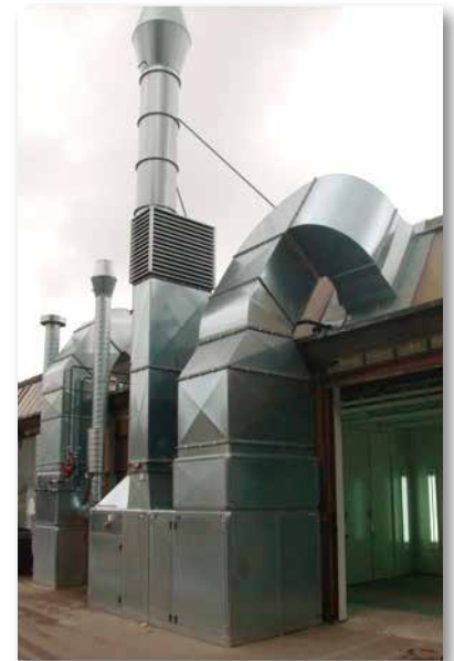
Aggregat med vattenvärmebatteri.
