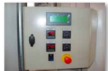
Kontrolltavla med PLC och digital pekskärm
